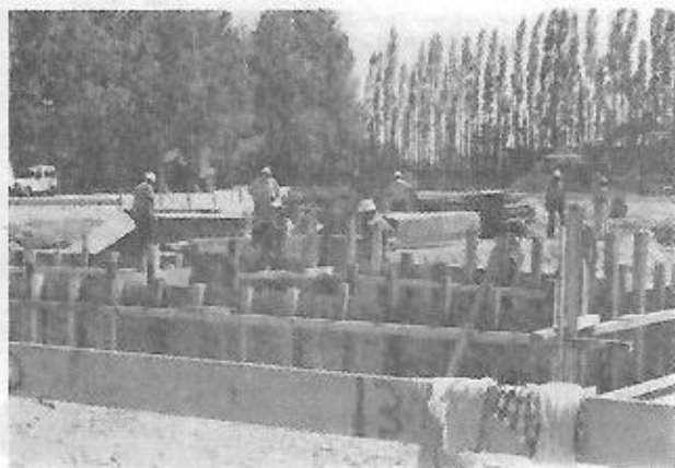
Đóng ván khuôn chuẩn bị đổ bê tông xây Chánh Điện (Hình ngày 19.6.1989)
