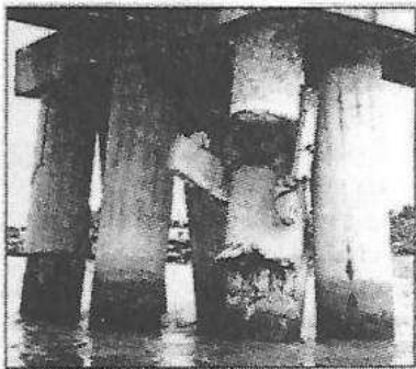
H1. Trụ cầu số 4 bị gãy
